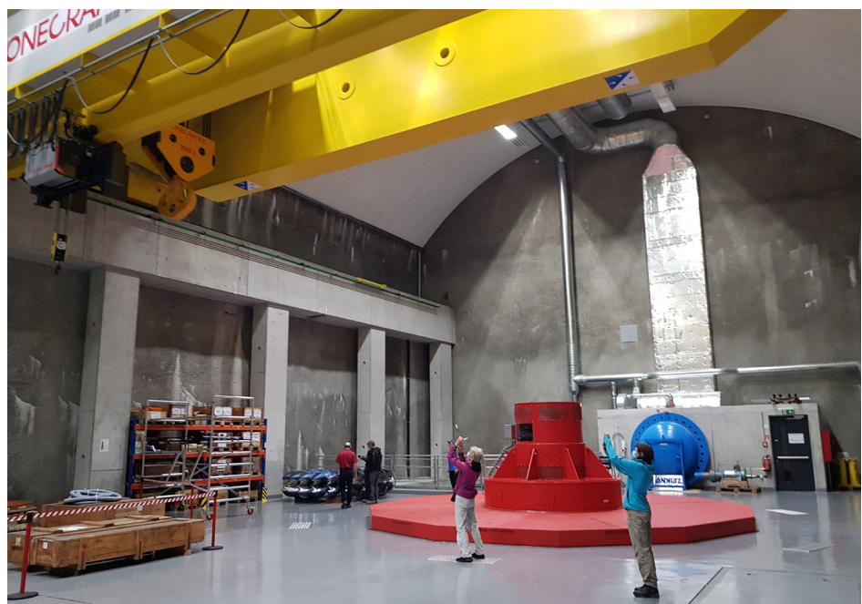
Ein Teil des KWO-Kraftwerks Innertkirchen. Die Dimensionen sind beeindruckend.
